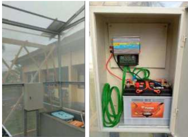
Gambar 4.1. Instalasi PLTS di Kebun Komunitas
